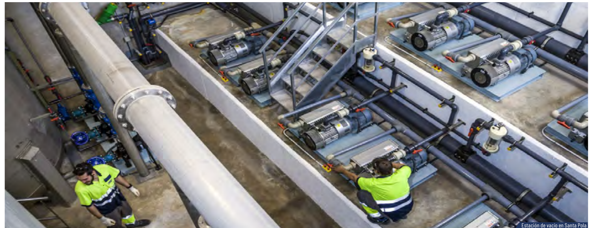
Estación de vacío en Santa Pola
